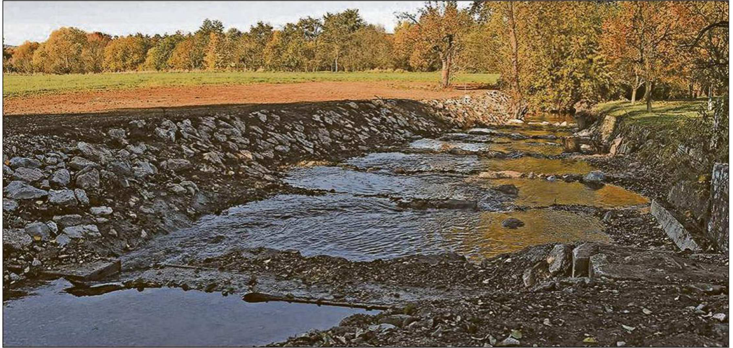
Die neue Fischtreppe am Wesebach kurz vor Mündung in die Eder.
